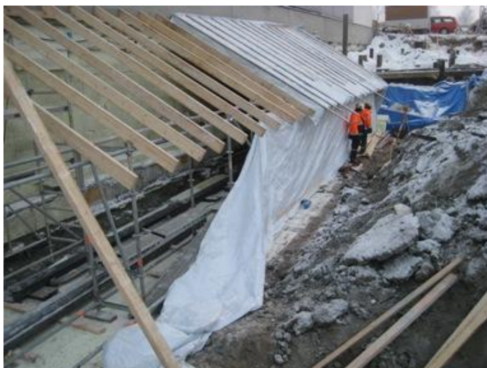
Parkkihallin vastaisen seinän sääsuojakatos.
